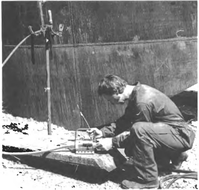
Figur 5. Gammaradiografianläggning. Den radioaktiva strålkällan förvaras i den blyskärm, på vilken manöverkabeln håller på att monteras. Vid exponeringen ligger strålkällan i stativet intill cisternen. (Från Tekniska Röntgencentralen, Stockholm.)
