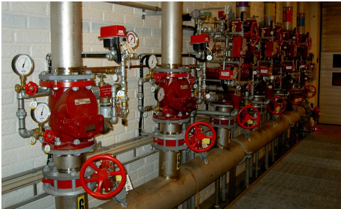
Figur 3. Sprinklercentral med sex sprinklersystem.
