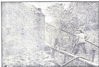
Fig. 1. Ändamålslost och oförsvarligt nedrivande av murverk.
