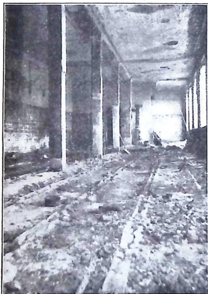
Fig. 3. Interiör av Vallendahls magasin efter branden.
