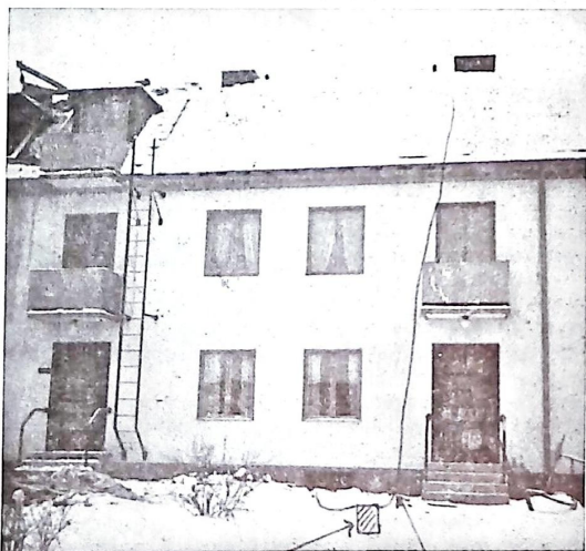
Bild 1. Transformatorns uppställning på gården och kablarnas läge. Till vänster skimtar eldstället. Obs. den övre kabelns kontakt med plåten vid takfoten.
