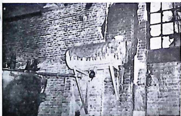
Bild 2. Expansionskärlets placering i förhållande till dels fönstret, dels transformatorn. Gasreläet var placerat mellan de två rördelarna.
