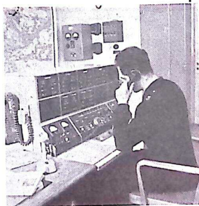
MANÖVERBORD med manöverorgan, provningsapparat och centralutrustning.
