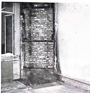
Bild 3. Ett av de brandskadade hotellrummen sedan den putsade trätrumman till hissens motriktor nedrivits.
