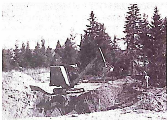
Bild 2. Grävningen utföres så att de upprävdade jordmassorna skall behöva omflyttas så litet som möjligt.
