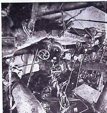
Bilden visar hur väggen till motorrummet har demolerat pumpen och rörledningar.
