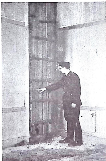
Bild 1. Branden spred sig via rörlitsen från pannrummet till vinden.
