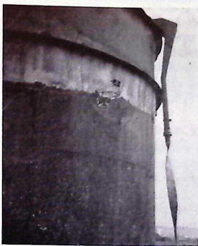
Bild 5. Begjutningshuvud uppbängt över kanten av cisternmanteln. Skummängd 3—3,5 m 3 /min från skumrör placerat i markplanet.
